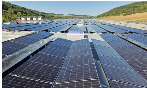
Autarke Stromversorgung durch PV-Anlage
